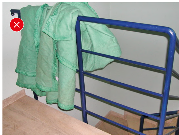
2. Non respect des espacements maximaux définis dans la norme. Effet d'échelle, sur palier d'escalier.
