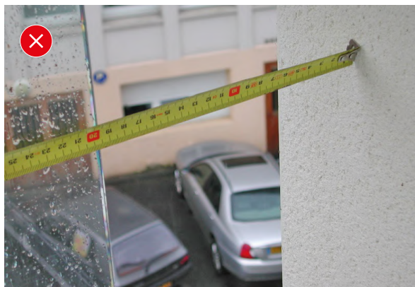
1. Non respect des espacements maximaux entre maçonnerie et garde-corps ou entre garde-corps entre-eux. Vide excessif entre garde-corps et maçonnerie proche.
